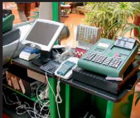
Situazione "arrangiata": utilizzo di banchi cassa della GDO con aggiunte estemporanee per carenza di contenimento attrezzature. Le attrezzature sono in situazione non protette con matasse di cavi a vista.
